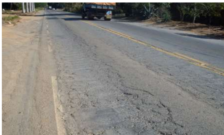
Figura 4 - Afundamento de consolidação.
