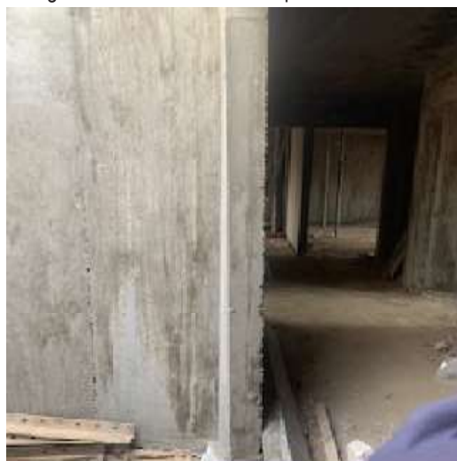
Figura 7 – Parede fora de esquadro do elevador.
