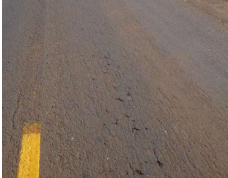
Figura 6 - Desgaste do pavimento.
