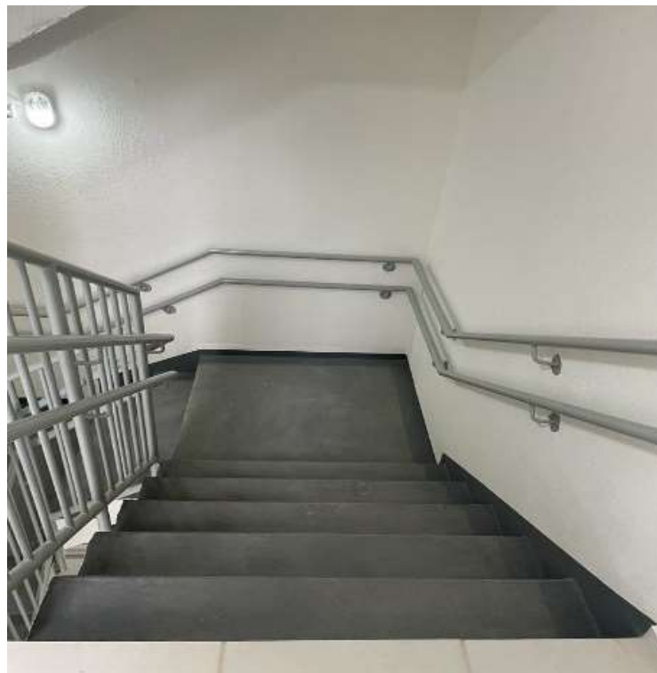
Figura 10 – Sinalização no degrau.
