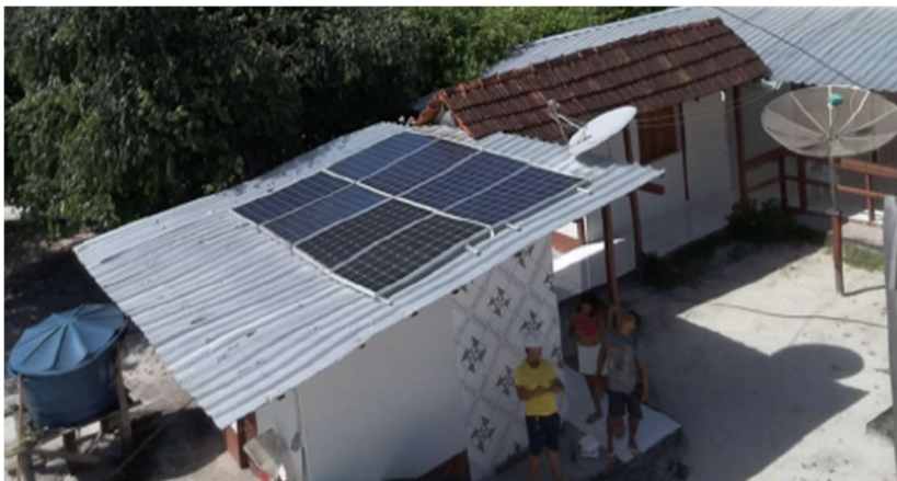
Figura 7 - Painéis solares instalados.
