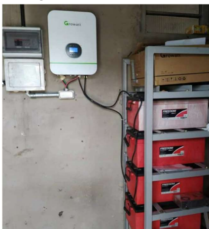
Figura 8 - Controlador de carga, inversor e banco de baterias do sistema instalado.
