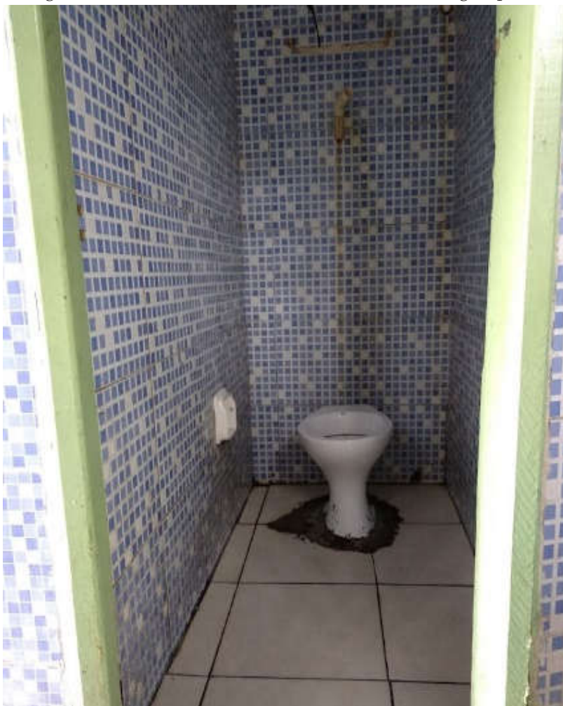
Figura 28: Sanitário masculino do centro sem descarga e porta
