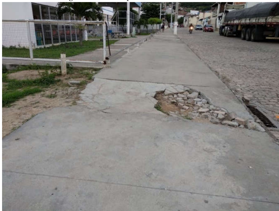
Figura 61: Passeio público do CEU danificado
