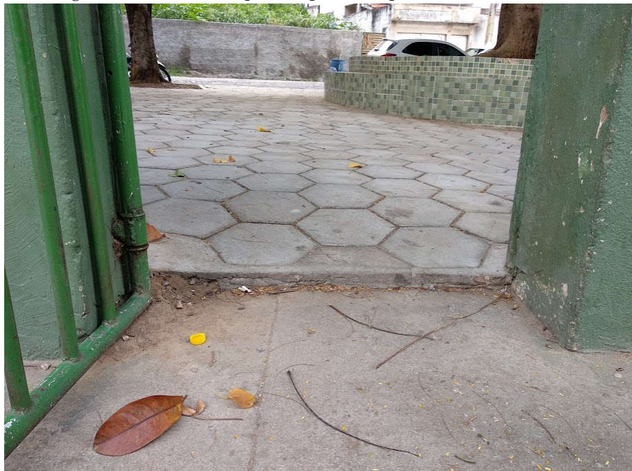
Figura 12: Desnível no piso da porta da quadra do Bairro Leader
