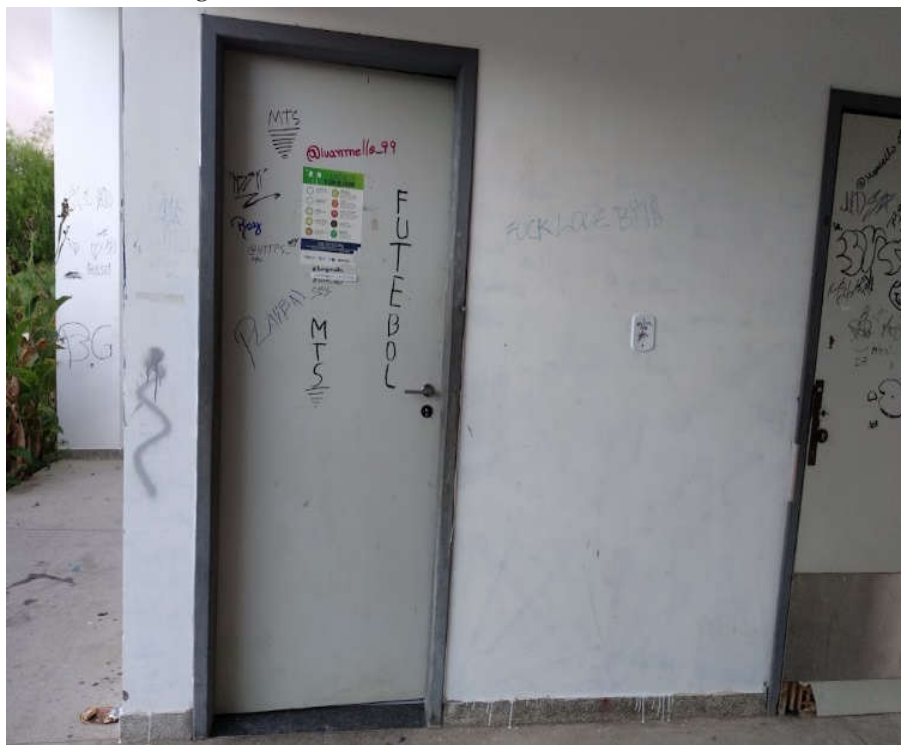
Figura 54: Porta de entrada do banheiro do CEU
