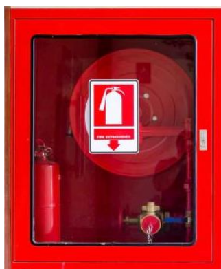
FIGURA 10: Imagem ilustrativa do extintor e mangueira de incêndio. FONTE: Google imagens.
